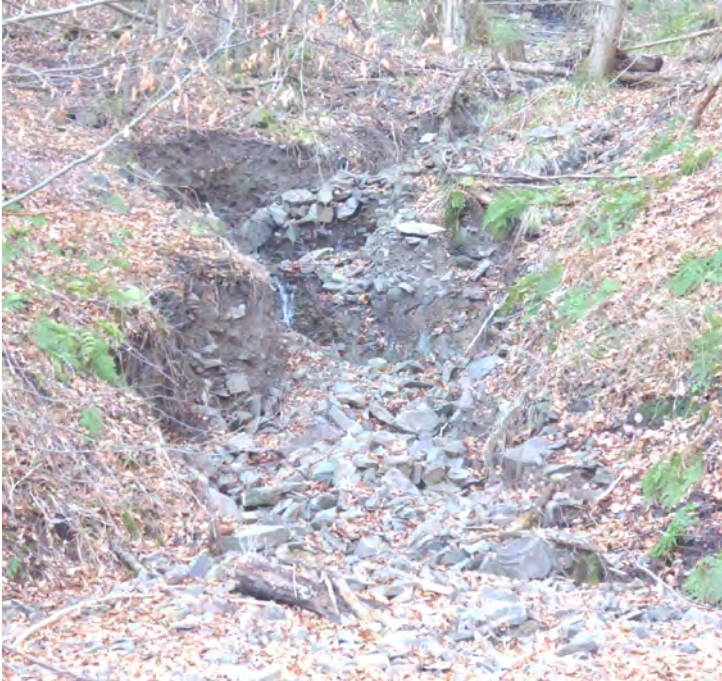
Bäche sind ausgespült Oder haben sich in Canyons verwandelt.
